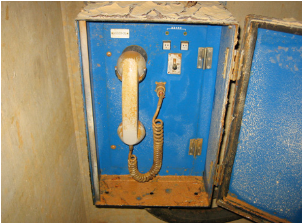
写真5 ハンドセットステーション冠水状況 (屋内壁掛型ハンドセットステーション)
