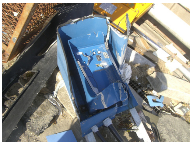
写真3 津波による破損状況 (屋外自立型ハンドセットステーション)
