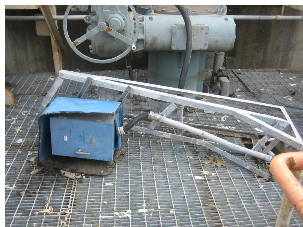
写真4 津波による破損状況 (屋外自立型ハンドセットステーション)
