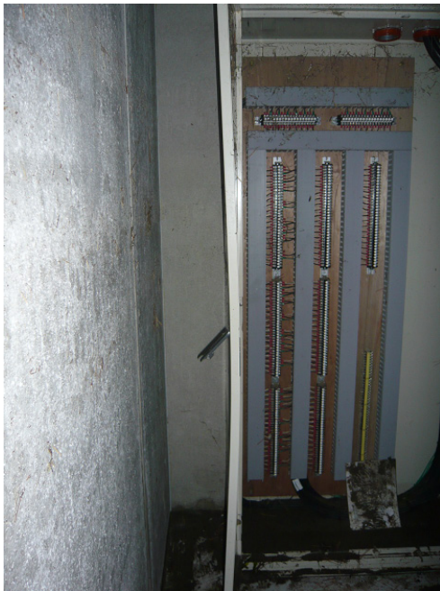
写真6 ケーブル分岐箱冠水状況
