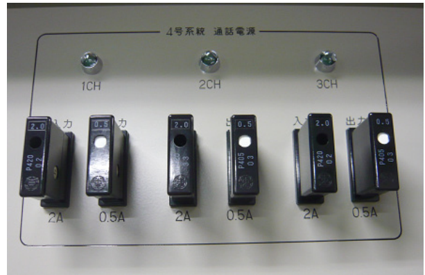
写真7 外線短絡・地絡による通話電源断（白丸）の状況
